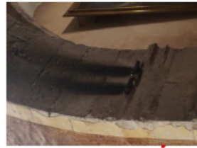
Parlements du chœur. L'éclairage actuellement en place dans l'église provoque des fortes salissures de couleur noire. A nettoyer
